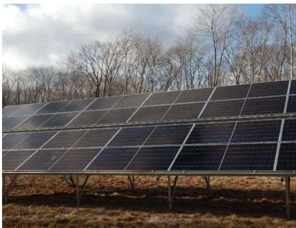
太陽光発電施設
