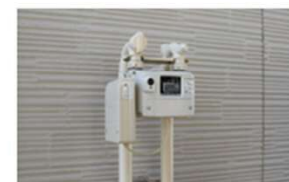
ガスマートメーター
