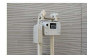
ガスマートメーター
