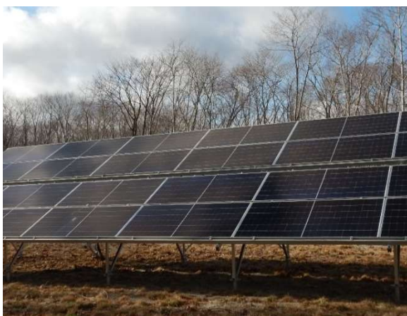
太陽光発電施設
