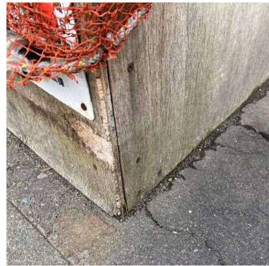
損傷状態を確認
