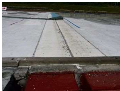
ハイランドスポーツセンター 屋外スケートリンクの劣化
