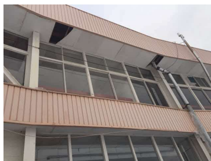
ハイランドスポーツセンター 施設の老朽化（築55年）
