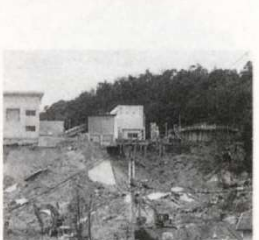
立入禁止(大きく陥没)
