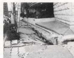
立入注意 (地割れの影響はない)
