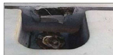
機体側破断面
