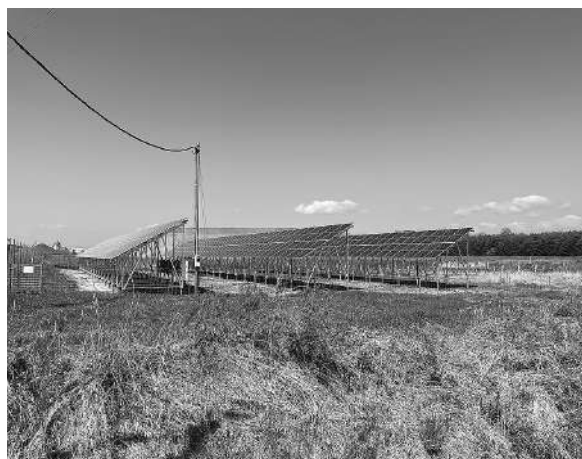
図8 調査ルート沿いの太陽光パネル
