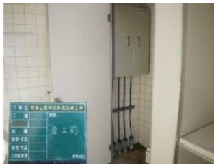
照明制御盤【着工前】
