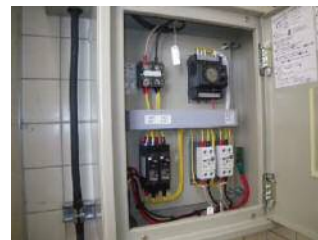
照明制御版【完成】
