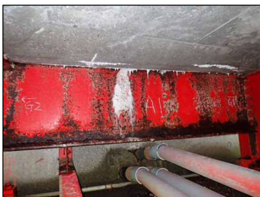
写真-7 鋼橋 塗装劣化・鋼材の腐食
