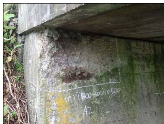
写真-8 下部工 コンクリートの剥離
