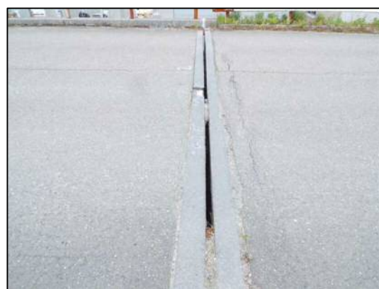
写真-10 伸縮継手止水ゴムの脱落
