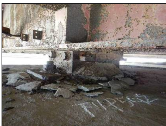
写真-9 支承モルタル損傷
