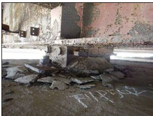
写真-9 支承モルタル損傷
