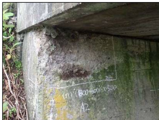
写真-8 下部工 コンクリートの剥離
