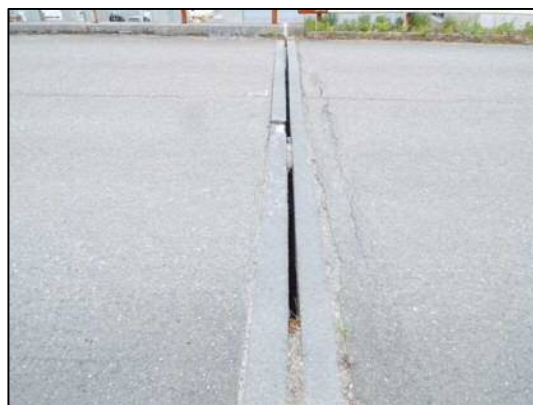
写真-10 伸縮継手止水ゴムの脱落
