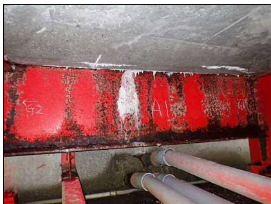
写真-7 鋼橋 塗装劣化・鋼材の腐食
