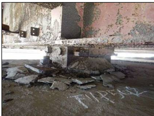
写真-9 支承モルタル損傷
