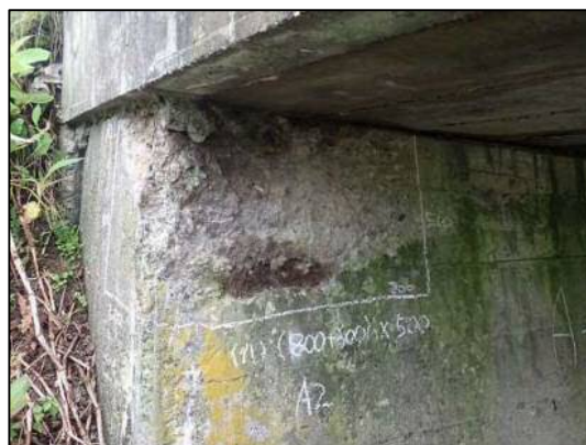
写真-8 下部工 コンクリートの剥離
