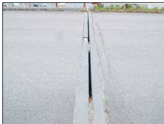
写真-10 伸縮継手止水ゴムの脱落
