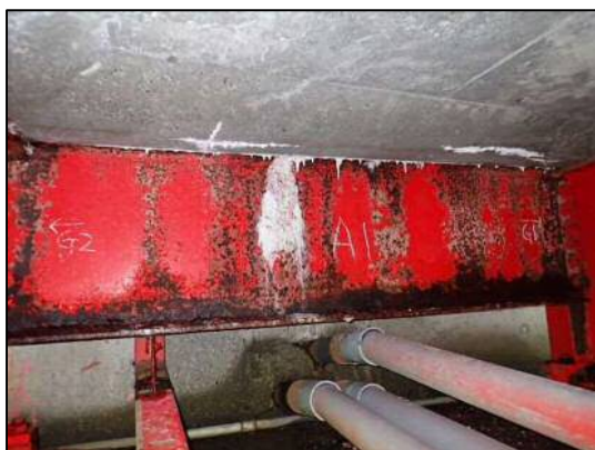
写真-7 鋼橋 塗装劣化・鋼材の腐食
