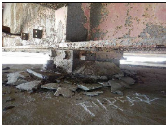
写真-9 支承モルタル損傷
