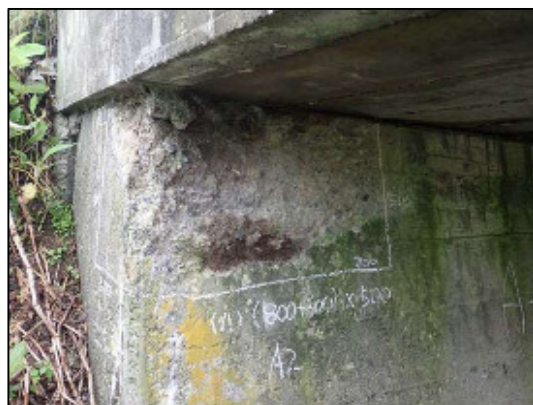
写真-8 下部工 コンクリートの剥離
