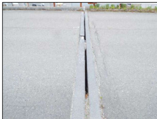
写真-10 伸縮継手止水ゴムの脱落
