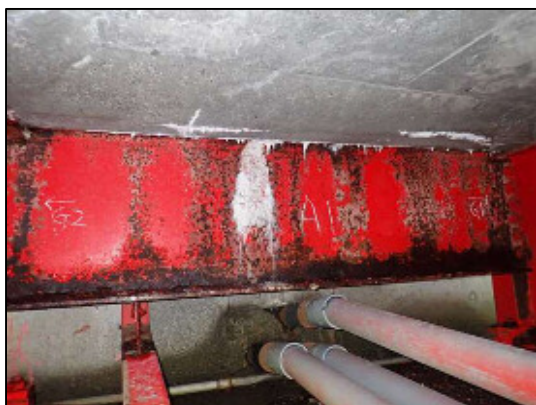
写真-7 鋼橋 塗装劣化・鋼材の腐食
