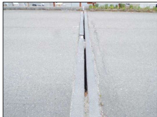
写真-10 伸縮継手止水ゴムの脱落
