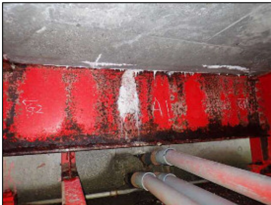
写真-7 鋼橋 塗装劣化・鋼材の腐食
