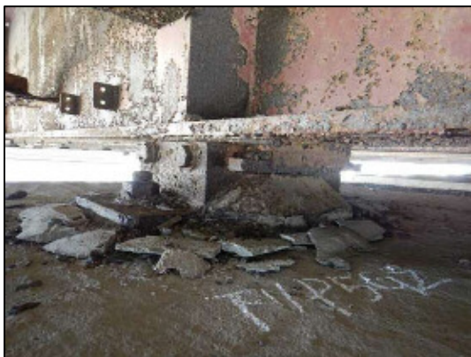
写真-9 支承モルタル損傷
