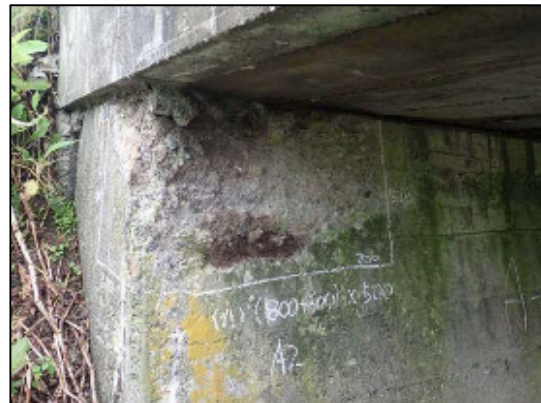
写真-8 下部工 コンクリートの剥離
