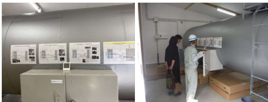
図 9-4 貯水タンクの使用・操作方法の確認
