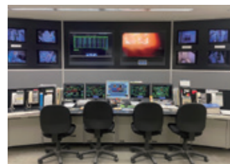
⑨ 中央制御室 施設内の安全かくにんや、機械の運転管理をするところです。
