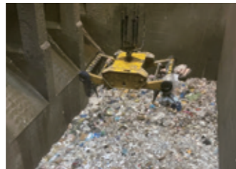
② ごみピット・ごみクレーン ごみピットにたまったごみは、クレーンでつかみ、焼却炉に入れます。
