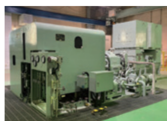
⑤ 蒸気タービン発電機 ボイラでつくられた蒸気を利用してタービンを回し、電気をつくります。
