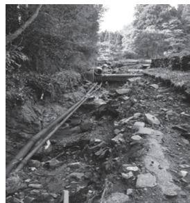
重茂南部浄水場への道路が損壊 水道管が露出している
