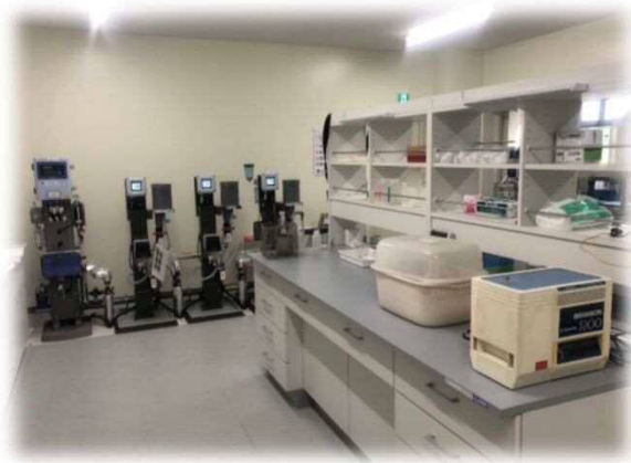
高丘浄水場新管理棟水質発信器室
