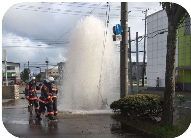
漏水が発生した水道管 (イメージ)
