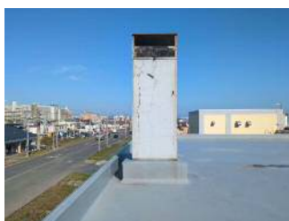
管理本館煙突（更新前）
