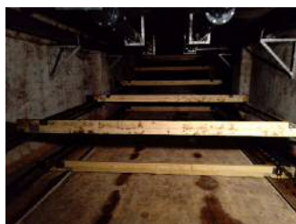
最終沈殿池設備（更新前）
