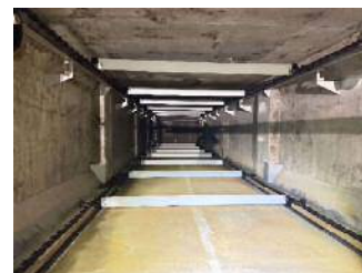
最終沈殿池設備（更新後）
