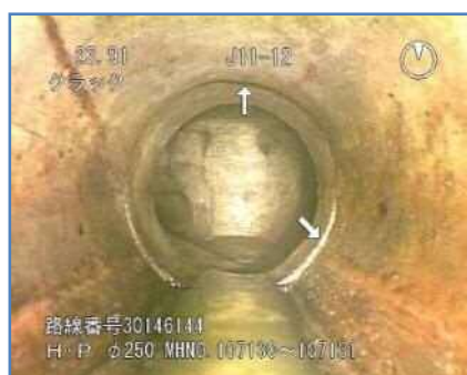
既設管渠の状況(カメラ調査結果)
