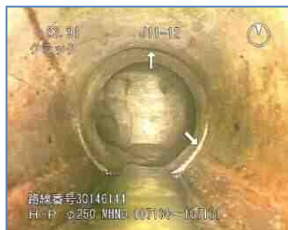
既設管渠の状況(カメラ調査結果)
