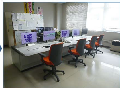
中央監視 (更新後)
