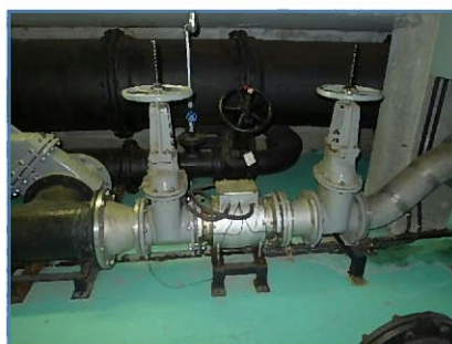
電磁流量計(更新前)
