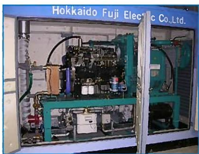
ガス発電機内部
