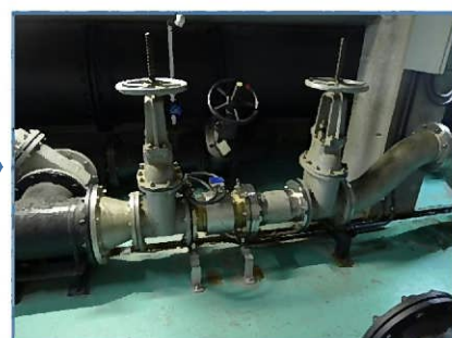
電磁流量計(更新後)
