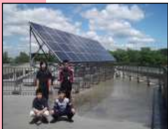
屋上の太陽光発電設備稼働中
