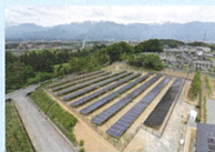
リユース品を使用した発電所
