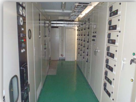
写真 3-2 狭隘化した電気室
