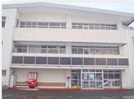
写真 3-5 設置した太陽光パネル
