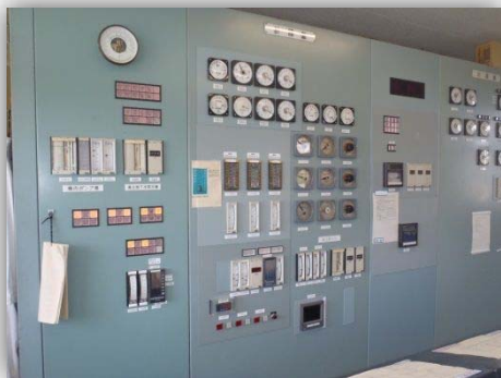
写真 3-1 老朽化した中央監視装置
