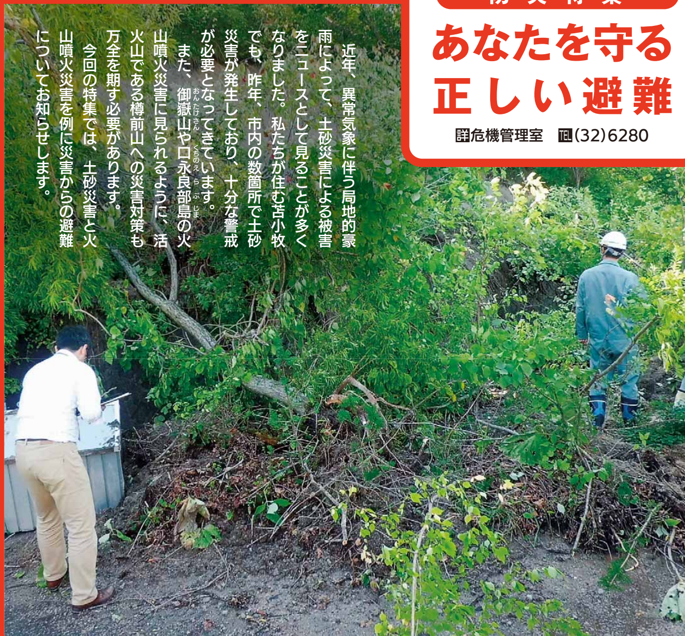
▲平成26年9月11日 有珠の沢町土砂災害発生現場
