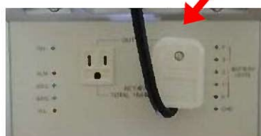
ACアウトレット (コンセント口)
