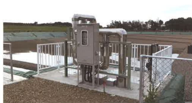
集水ピット設備
