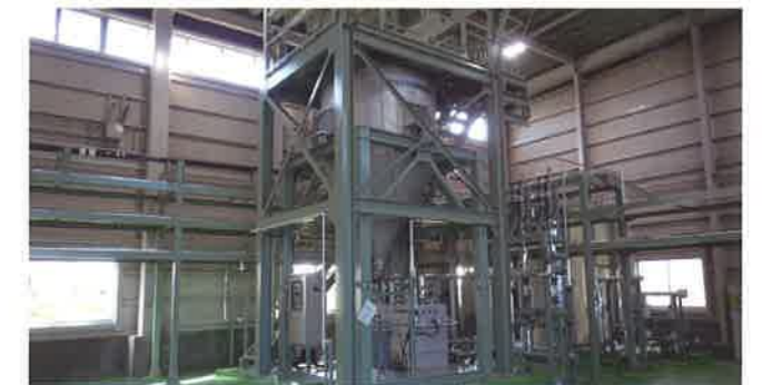
カルシウム除去剤貯槽
