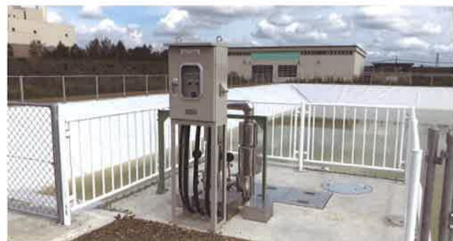
調整池ピット設備
