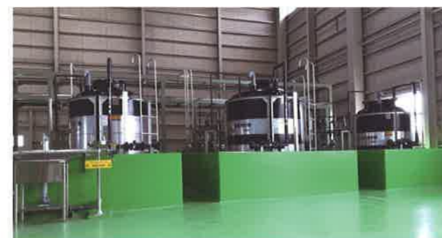
薬品注入設備
